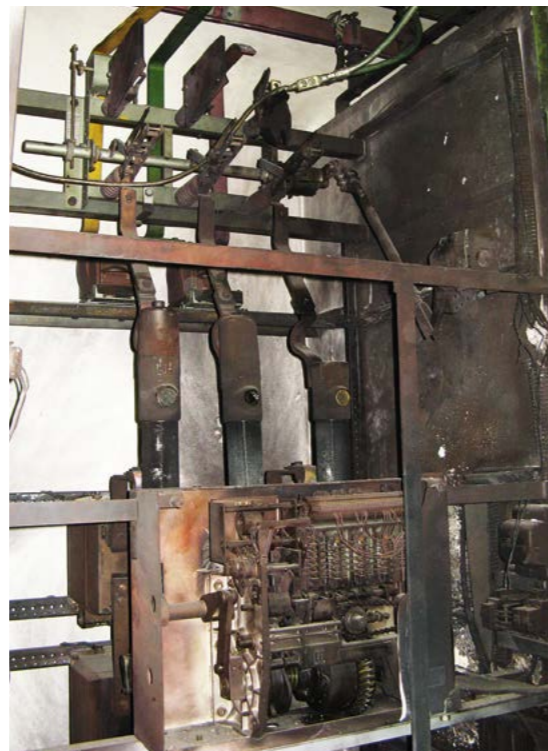
Ein zerstörter Schalter in der alten Ausführung
